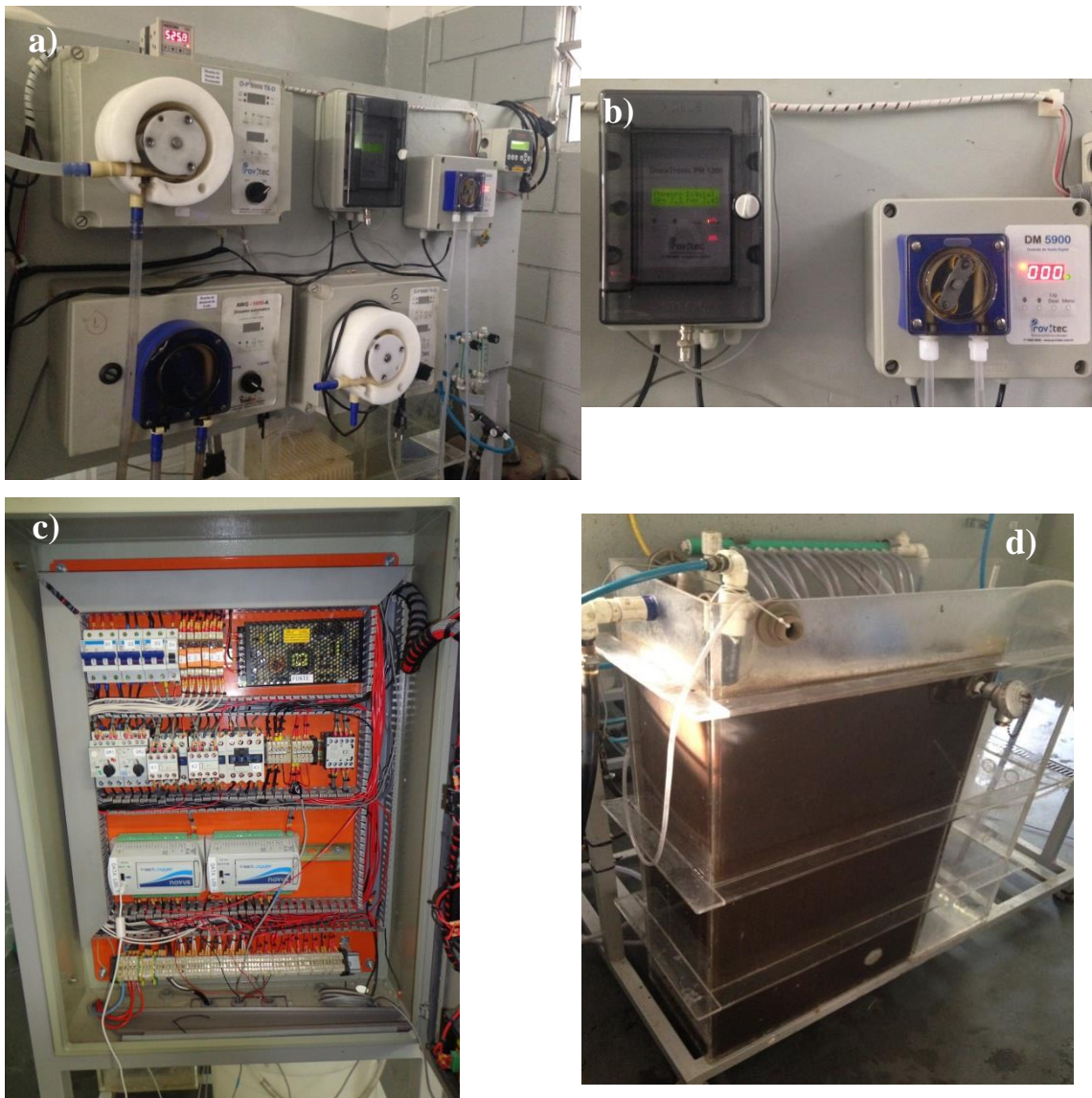
Figura 5 - a) visão geral dos equipamentos de monitoramento e controle; b) controlador de pH; c) painel elétrico; d) Biorreator de Membranas Submersas.
